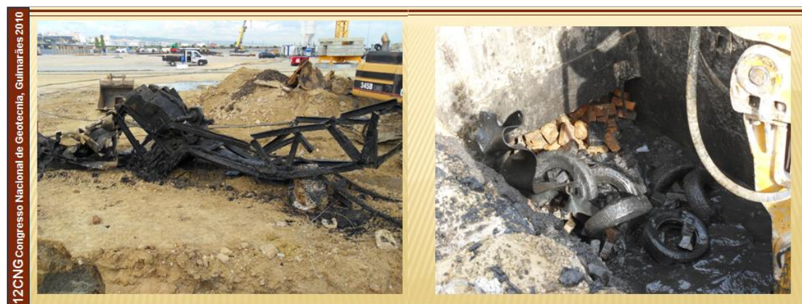
Figura 11 – Evidências de Entulho diversificado no interior das Estruturas Enterradas.
