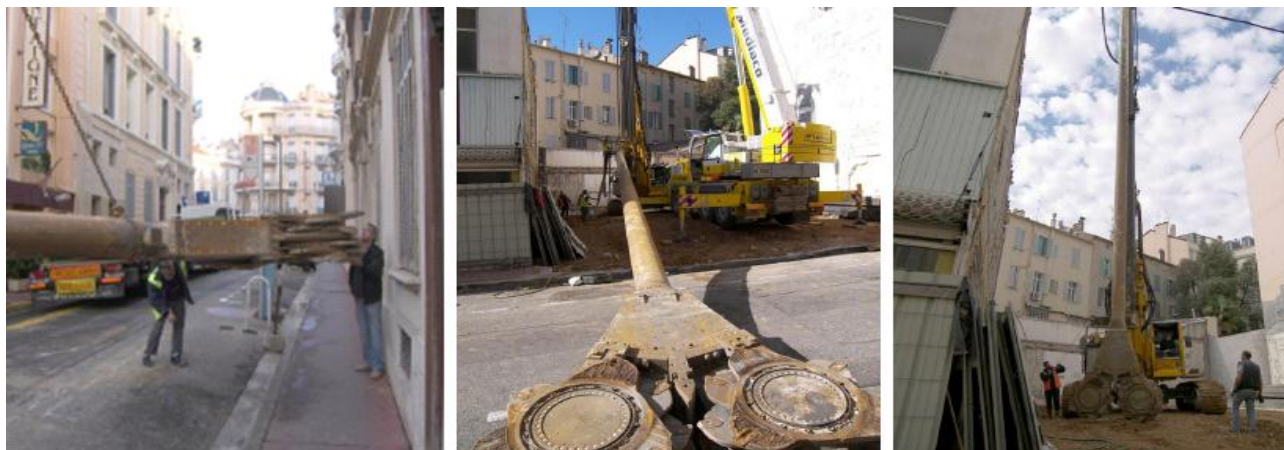
Figura 4 – Instalação do Equipamento
