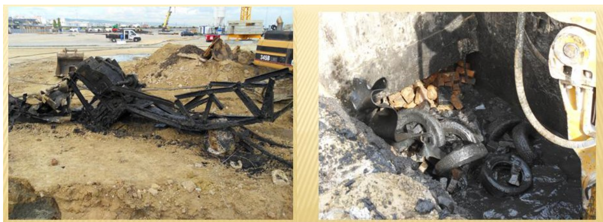
Figura 5 – Evidências de entulho diversificado no interior das Estruturas Enterradas.
